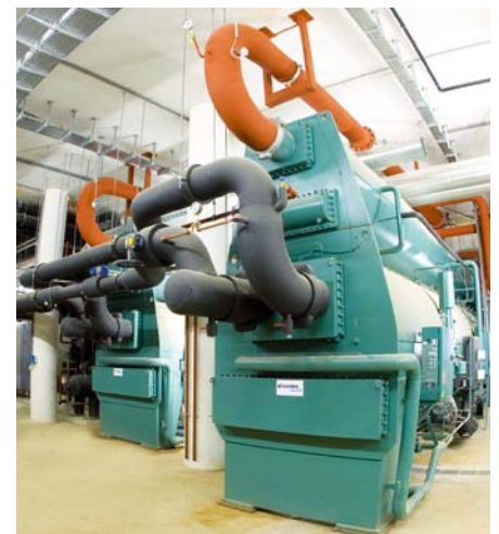
Fernkältezentrale Spittelau, Fernwärme Wien
